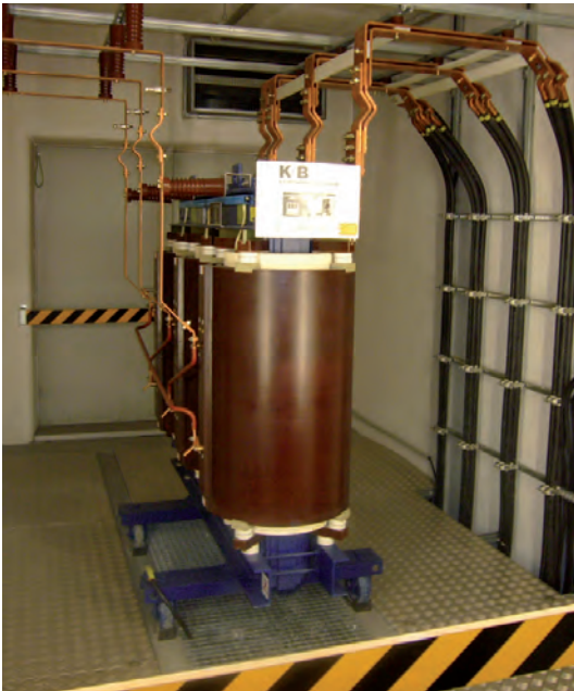
Einer der 107 Transformatoren
